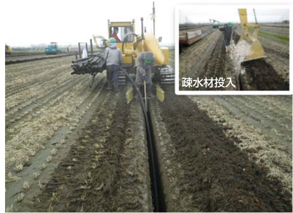
農地耕作条件改善事業 にしつがるちよだ 西津軽千代田地区（つがる市）
