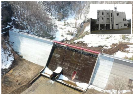
防災ダム事業 夏坂ダム地区（田子町、R3～R8） 防災ダムの施設改修
