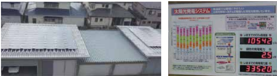
図4-24 三八地域県民局八戸合同庁舎太陽光パネルと三八地域県民局八戸合同庁舎太陽光発電モニター
