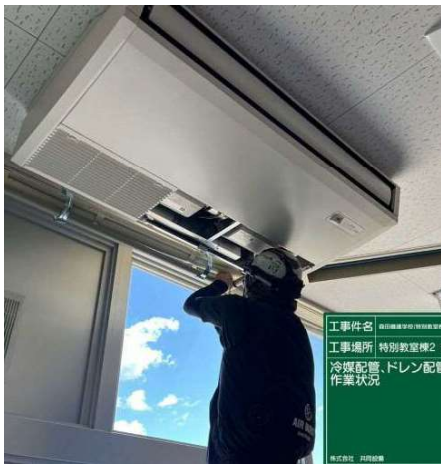
エアコン室内機
