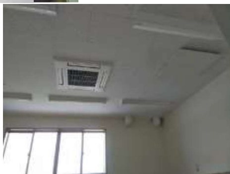
エアコン室内機
