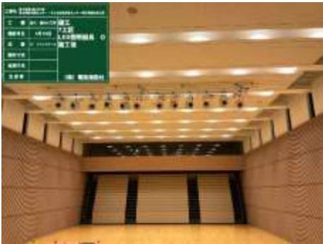
LED照明（イベントホール）
