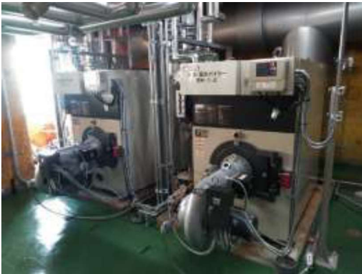
温水発生機（更新後）
