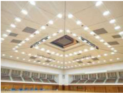
主競技場照明更新後（LED化）
