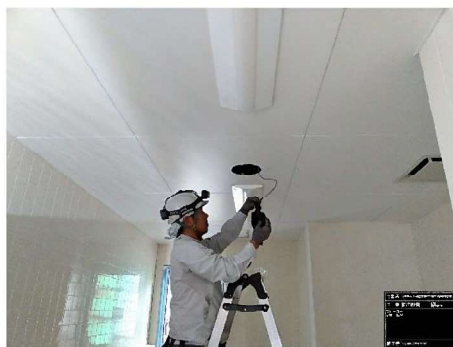
天井埋込スピーカ 取付状況
