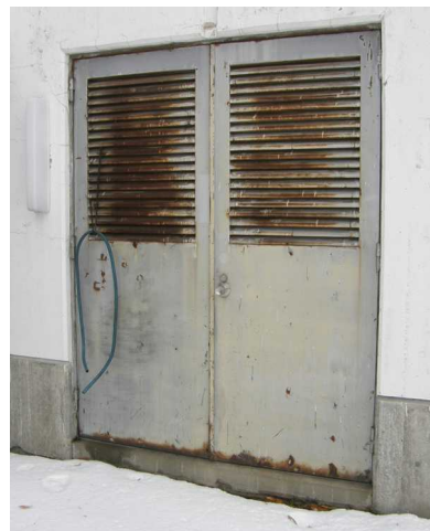
鋼製建具の腐食（ガラリ）
