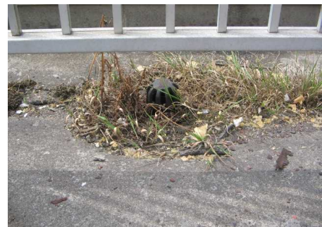
ルーフドレンの詰り(雑草が繁茂状態)ここまできると最悪です。
