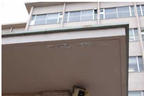
軒裏のはく離
