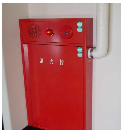
屋内消火栓箱（露出型）
