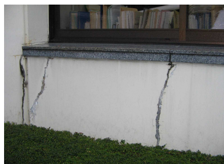
外壁仕上げのひび割れ
