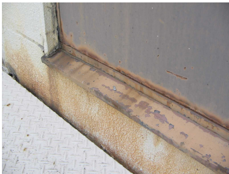
鋼製建具の腐食（水切）
